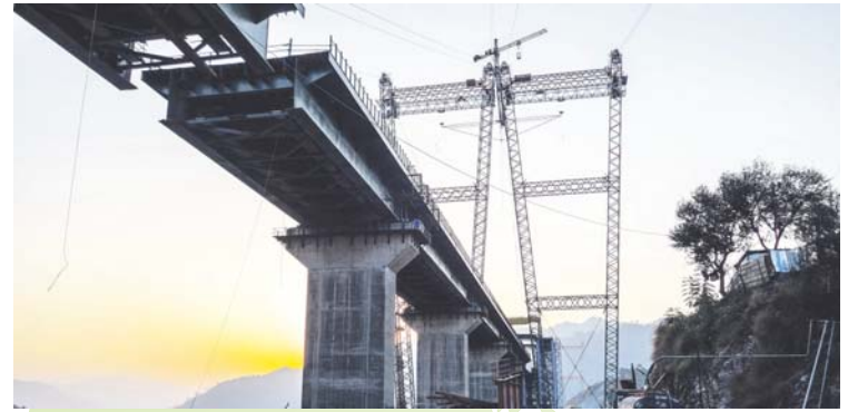
Bei der Chenab-Brücke in Indien, der größten Eisenbahnbogenbrücke der Welt, kam das flüssige Futterblech von Diamant Polymer aus dem niederrheinischen Mönchengladbach zum Einsatz. Das Bauwerk überspannt den Fluss Chenab in einer Höhe von 359 m. Foto: Diamant Polymer
